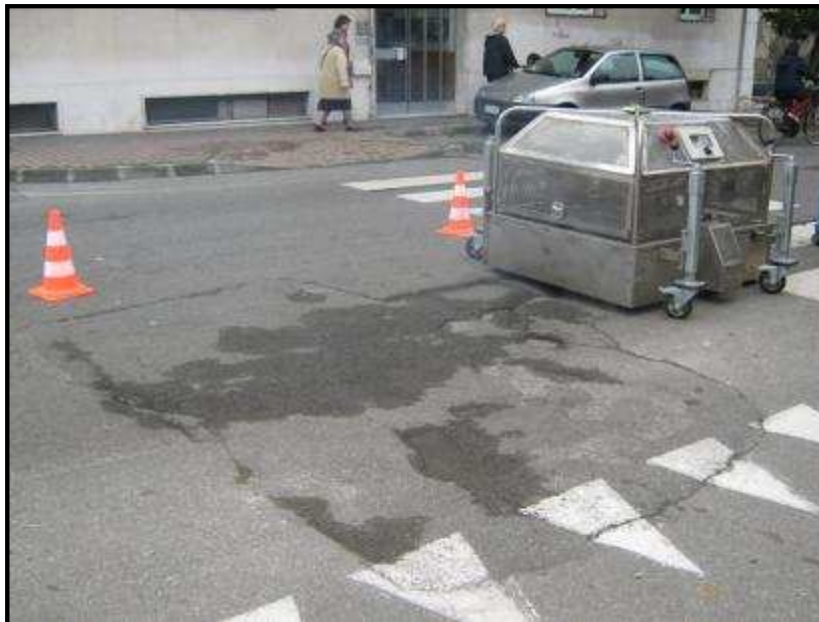
Condition de l'enrobé avant l'application du Rhinopatch
