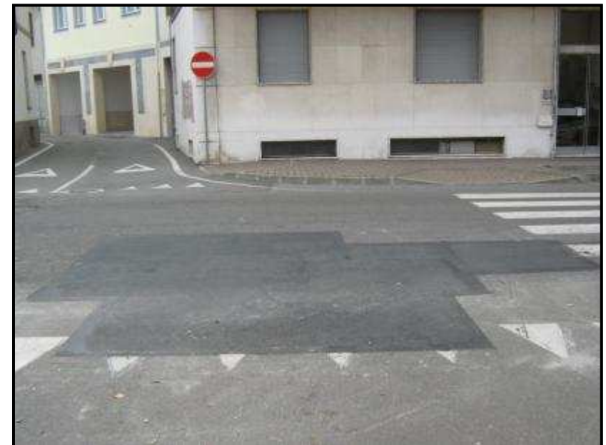
Condition de l'enrobé après
