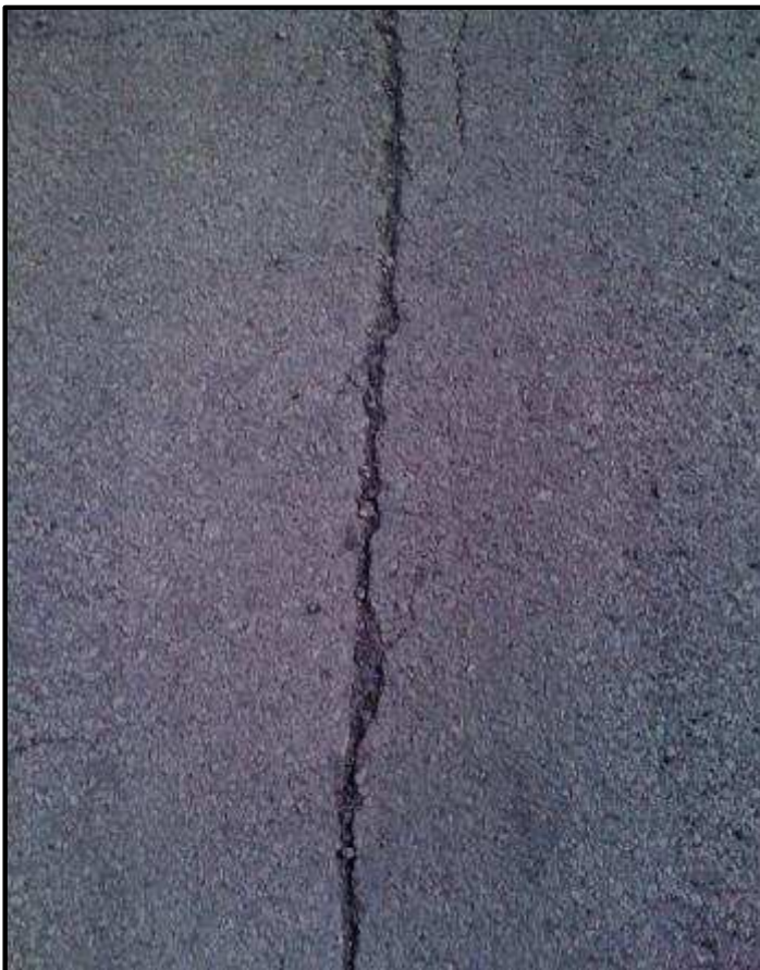
Fissure longitudinale sur enrobé
